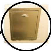
GARBAGE CHUTE PER FLOOR
